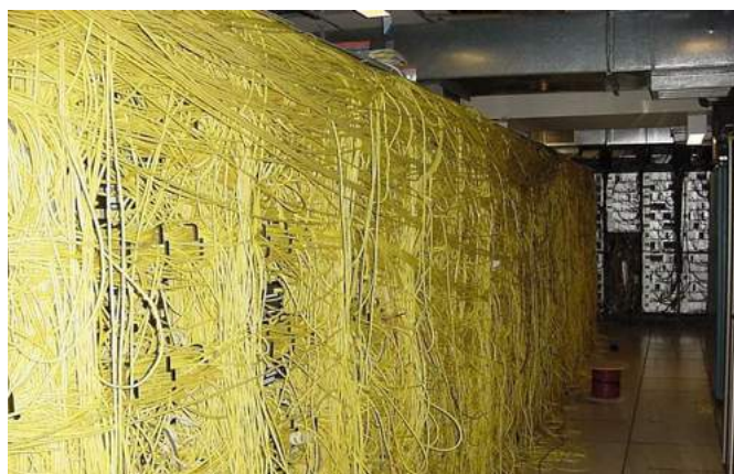
Zdjęcie. Okablowanie niestukturalne
